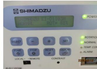
ノーマル切り替わり時操作盤
